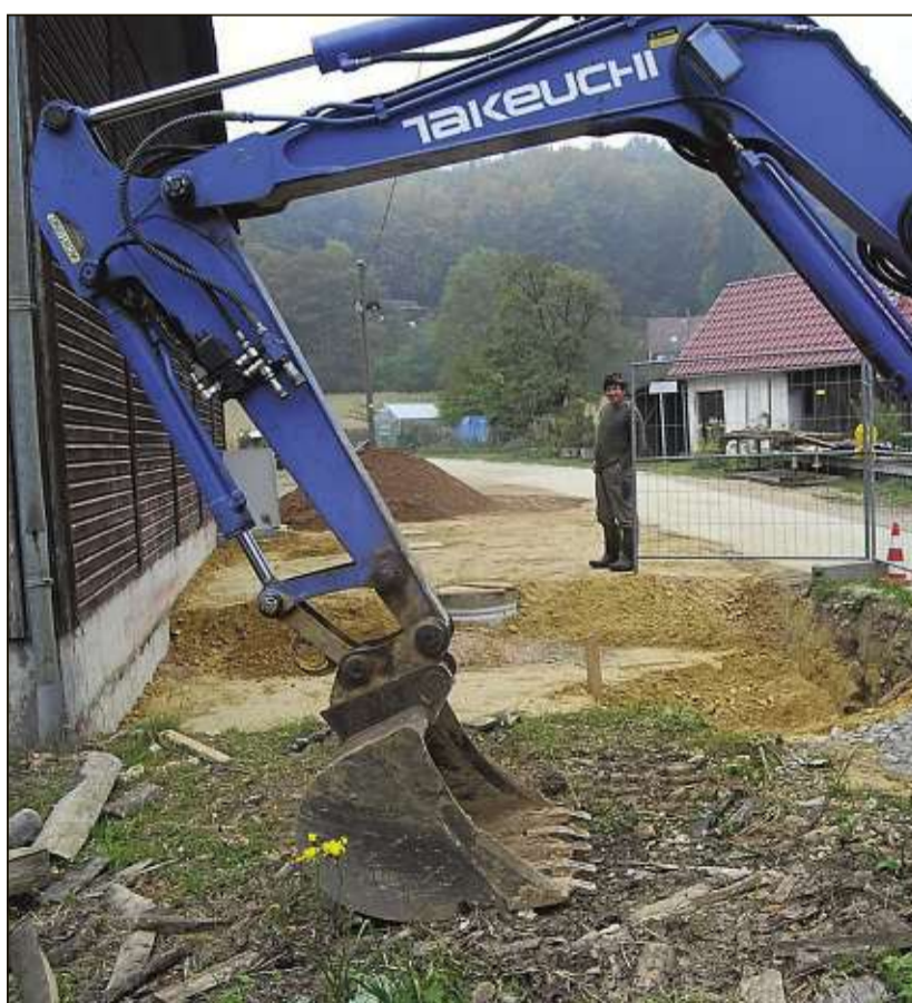
Die neue Gemeinschaftskläranlage ist auf dem Grundstück von Hans Bernet seit wenigen Tagen in der Erde. Foto: Volz
